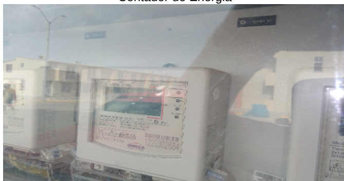
Contador de Energia
