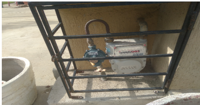
Contador de Gas
