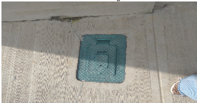
Contador de Agua
