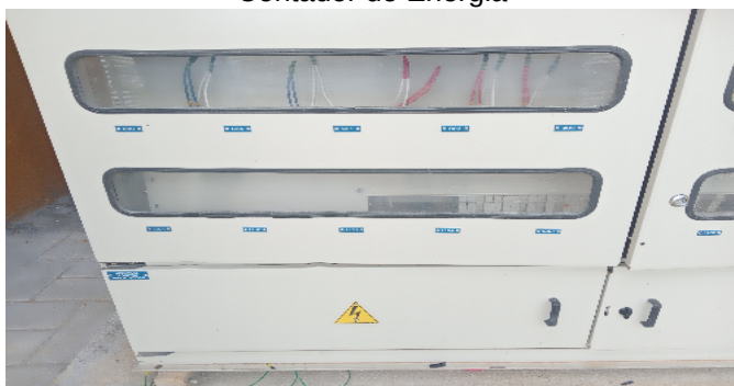
Contador de Energia
