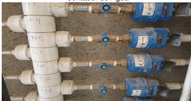
Contador de Agua
