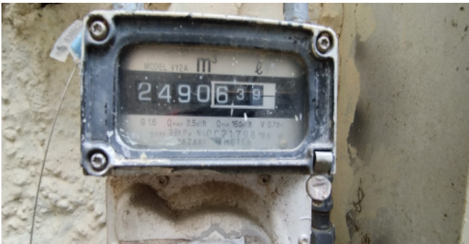
Contador de Gas
