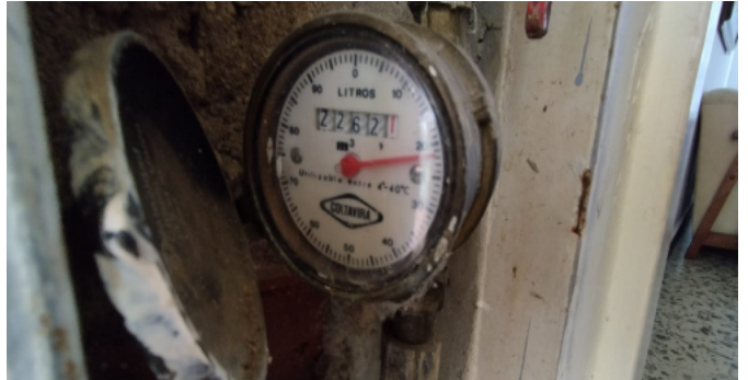
Contador de Agua
