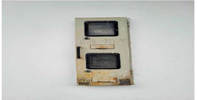
Contador de Energia
