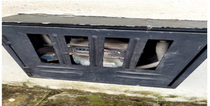
Contador de Gas
