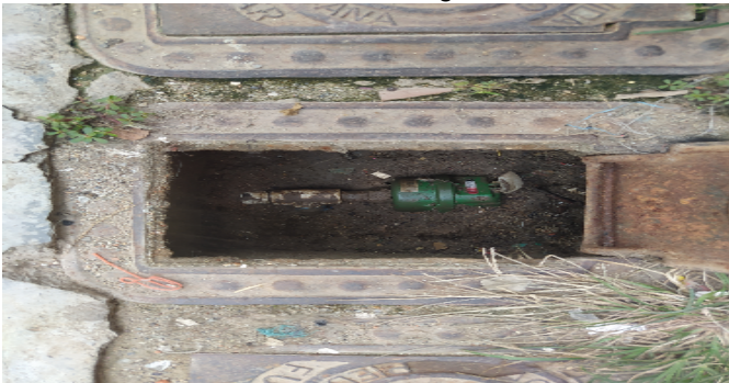
Contador de Agua
