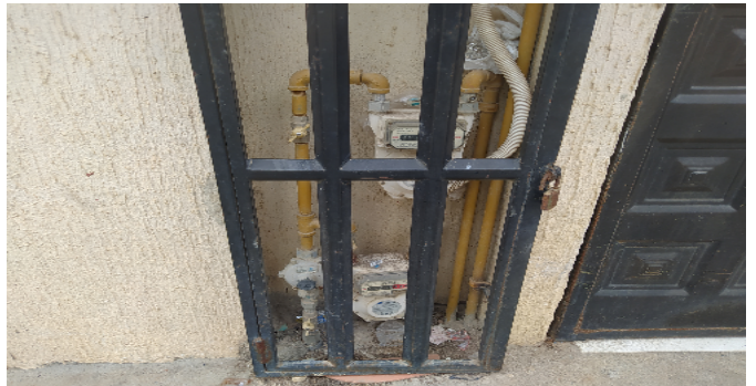
Contador de Gas
