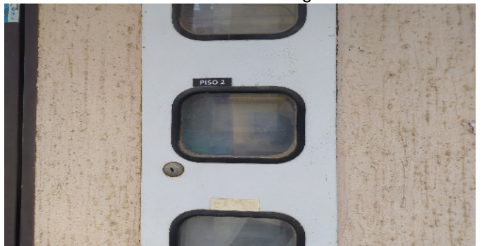
Contador de Energia
