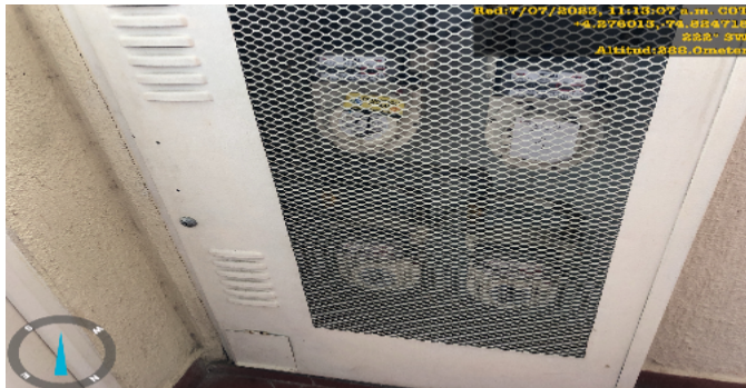
Contador de Gas
