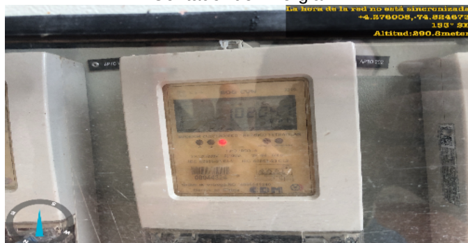
Contador de Energia
