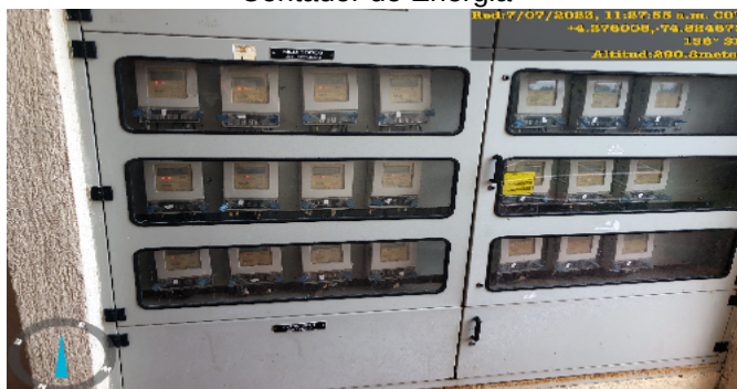
Contador de Energia
