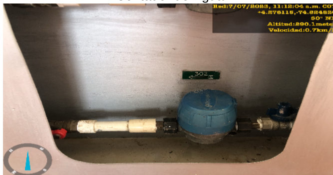
Contador de Agua
