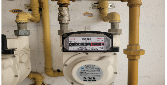
Contador de Gas
