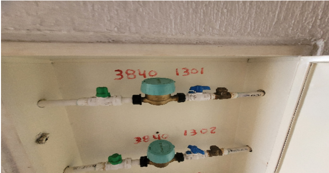
Contador de Agua
