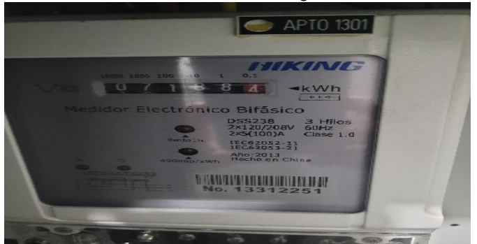
Contador de Energia
