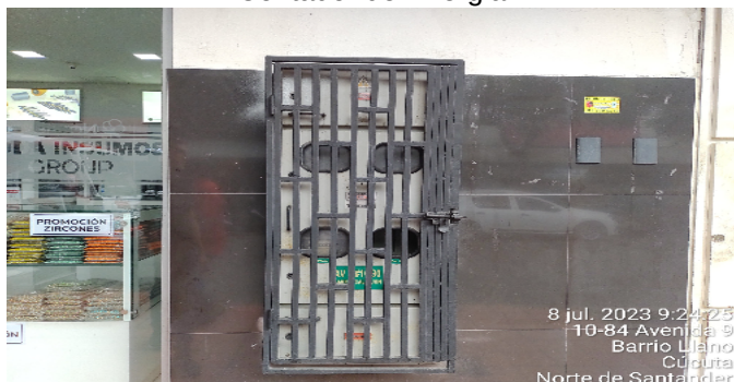
Contador de Energia
