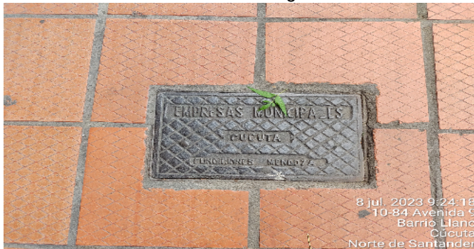
Contador de Agua
