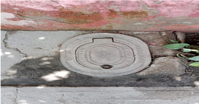
Contador de Agua
