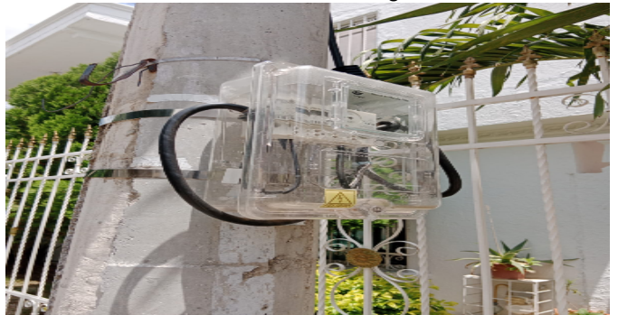
Contador de Energia
