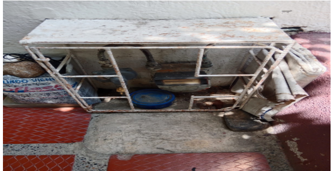
Contador de Gas
