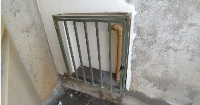
Contador de Gas
