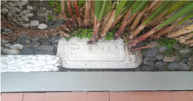
Contador de Agua
