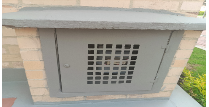
Contador de Gas
