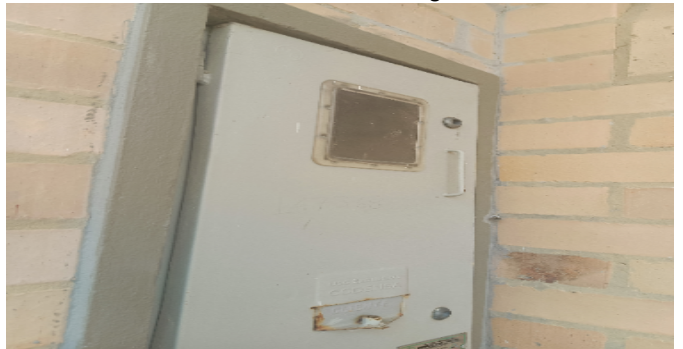
Contador de Energia
