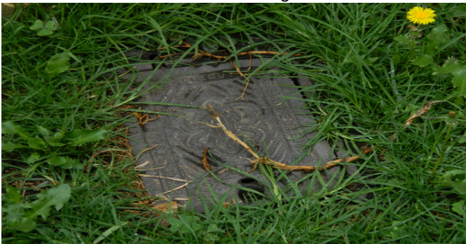
Contador de Agua
