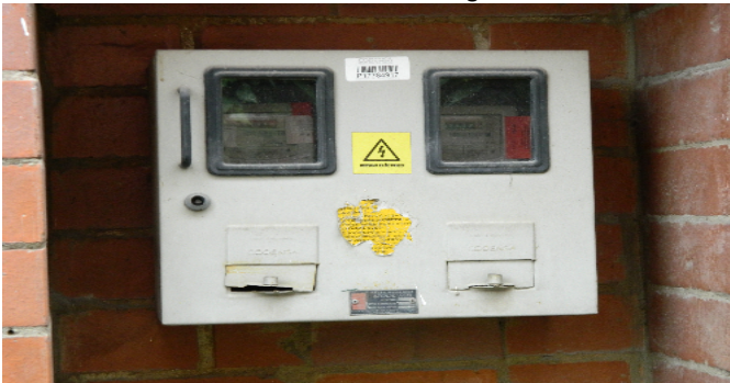
Contador de Energia
