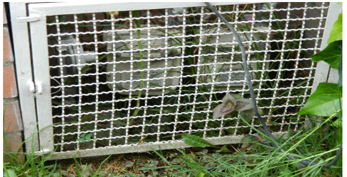
Contador de Gas
