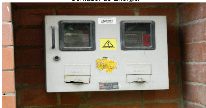
Contador de Energia
