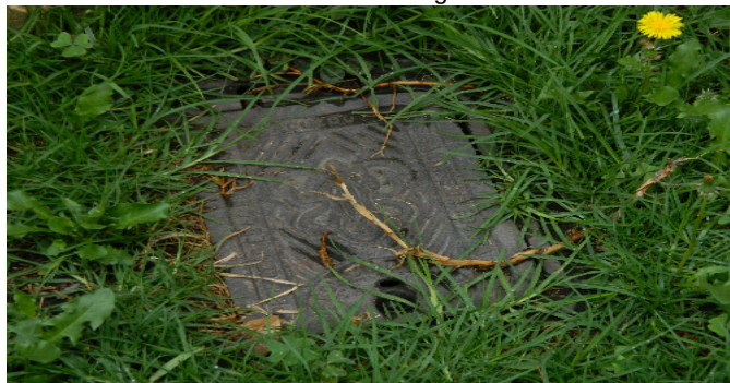
Contador de Agua
