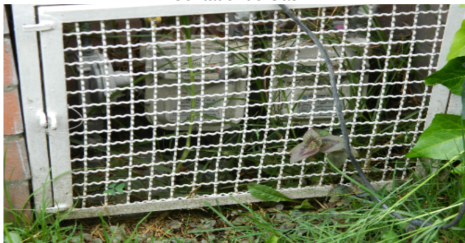
Contador de Gas
