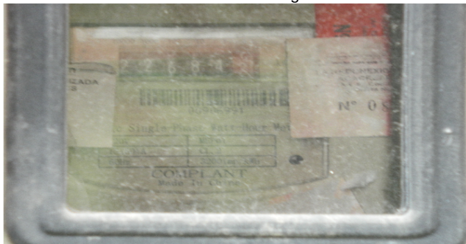
Contador de Energia
