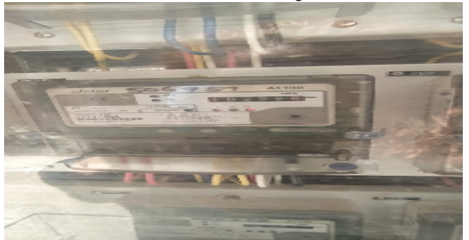
Contador de Energia
