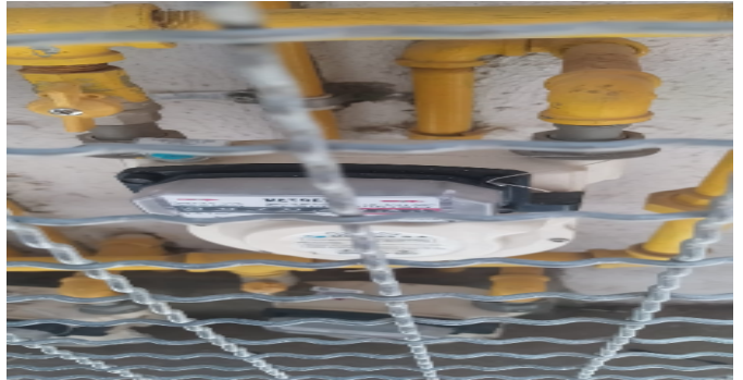
Contador de Gas
