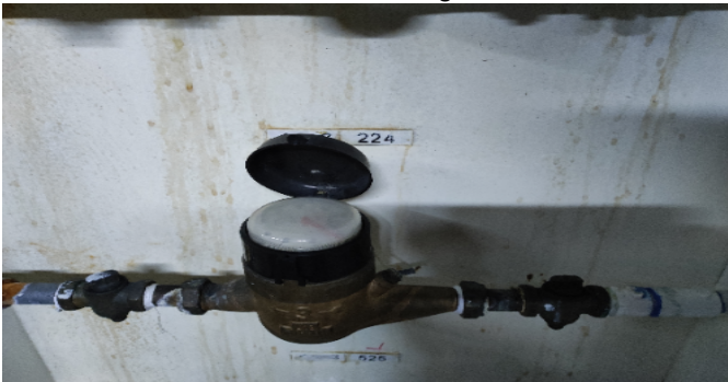
Contador de Agua
