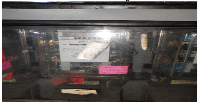
Contador de Energia
