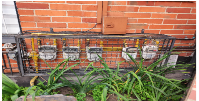
Contador de Gas
