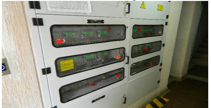
Contador de Energia
