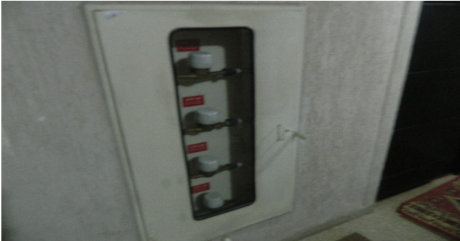
Contador de Agua
