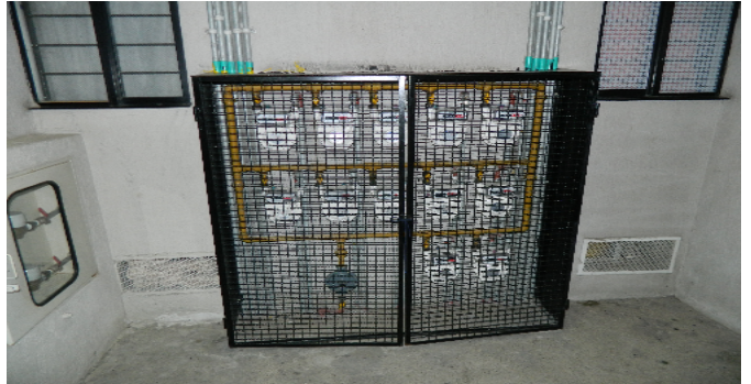
Contador de Gas
