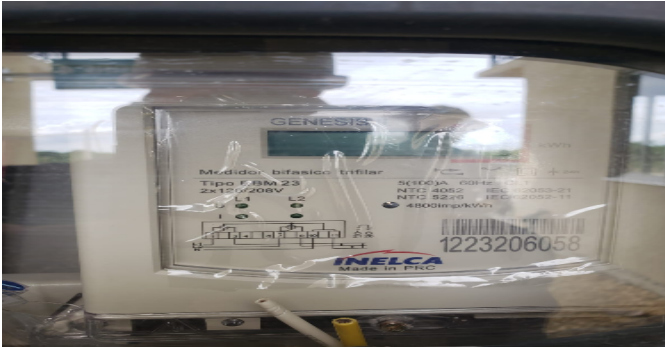
Contador de Energia
