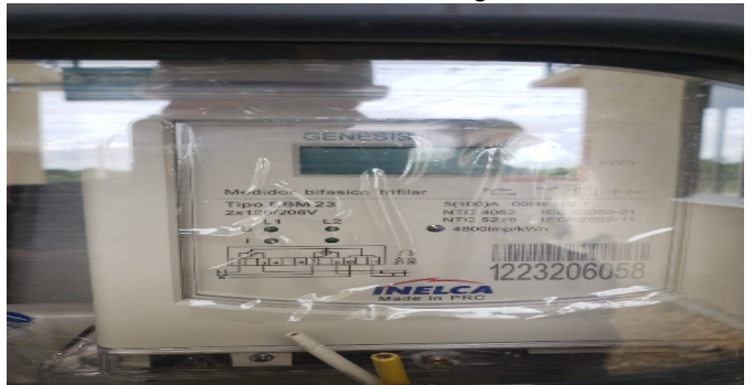
Contador de Energia
