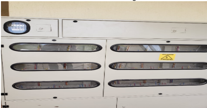
Contador de Energia
