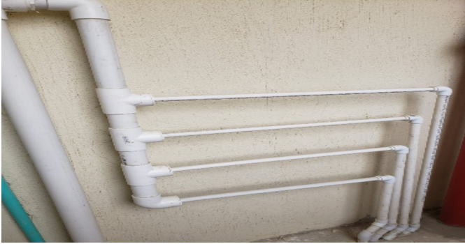
Contador de Agua
