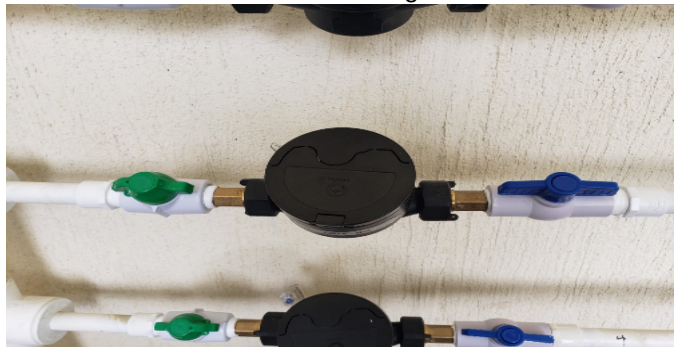
Contador de Agua
