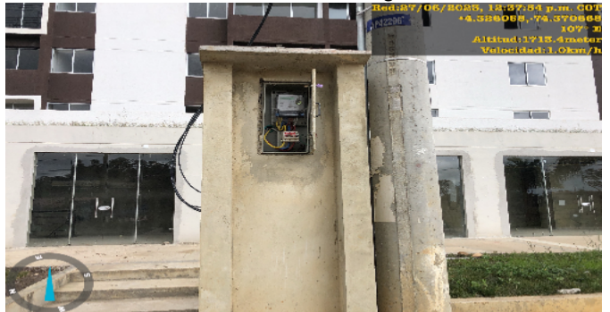
Contador de Energia
