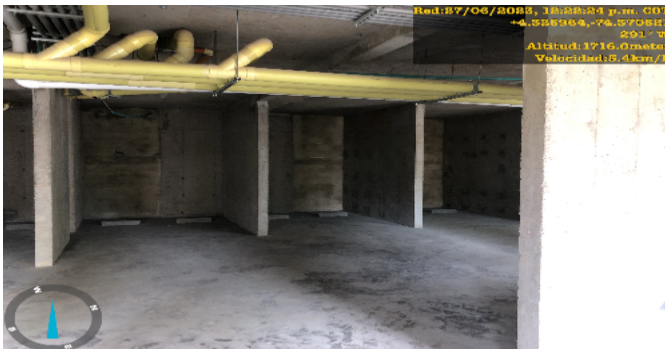
TUNERIA SANITARIAS Y DEMARCACIONES SIN HACER
