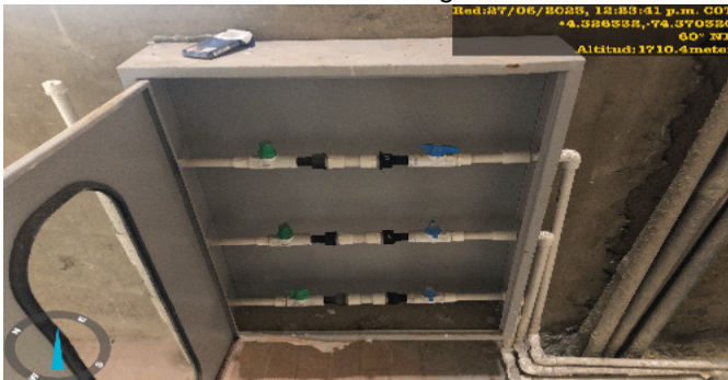
Contador de Agua
