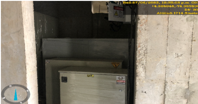
Contador de Energia
