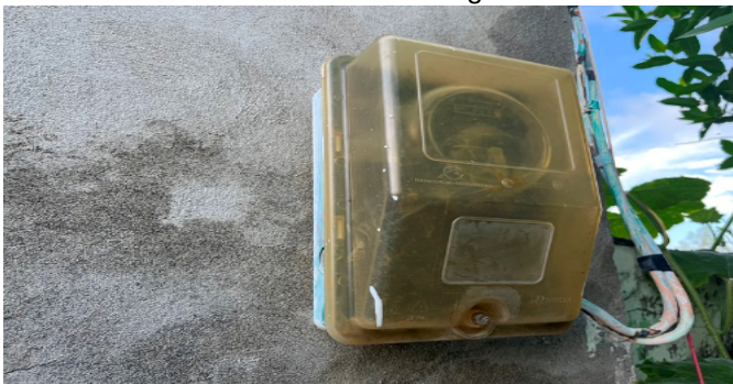
Contador de Energia
