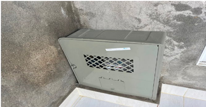
Contador de Gas
