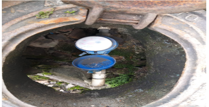
Contador de Agua
