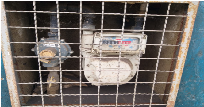
Contador de Gas
