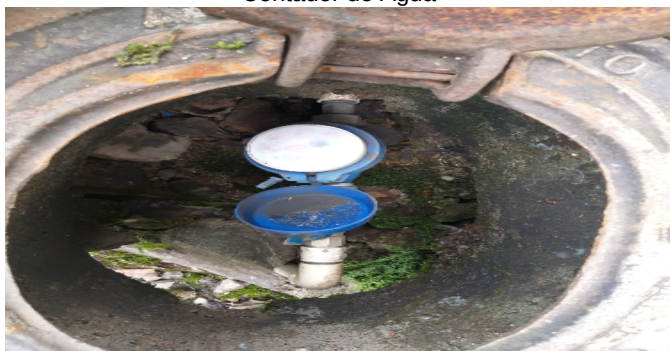
Contador de Agua
