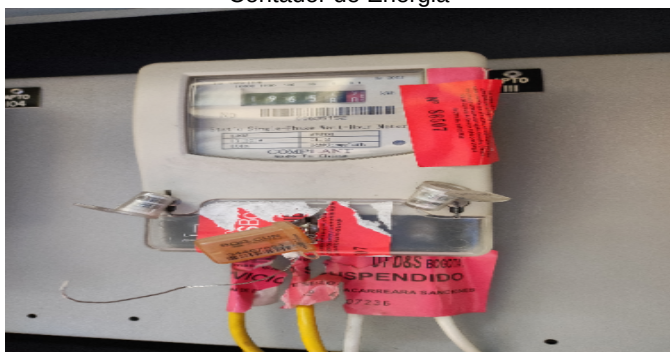
Contador de Energia
