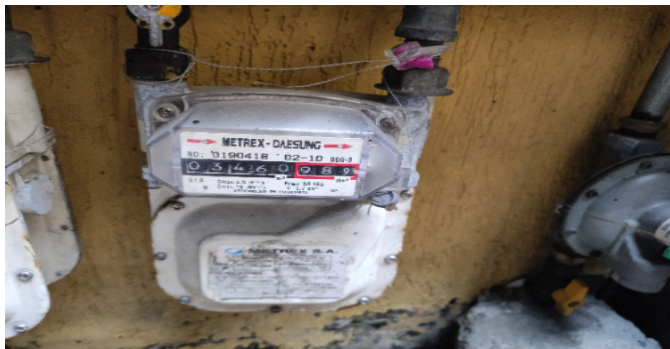
Contador de Gas
