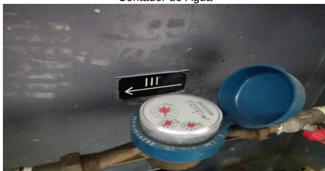
Contador de Agua
