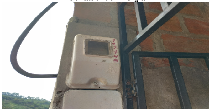
Contador de Energia
