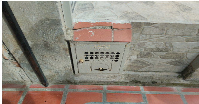
Contador de Gas
