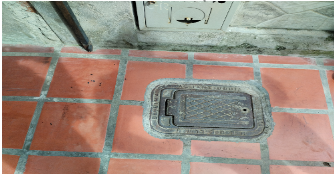
Contador de Agua
