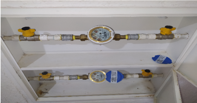
Contador de Agua
