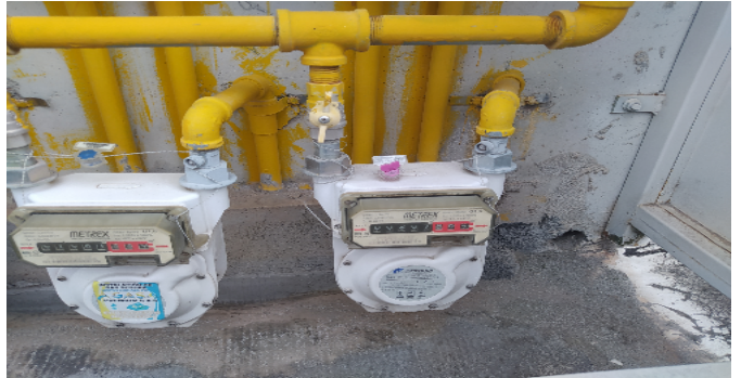
Contador de Gas
