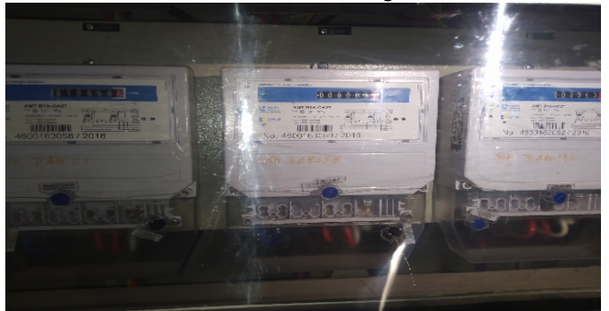
Contador de Energia
