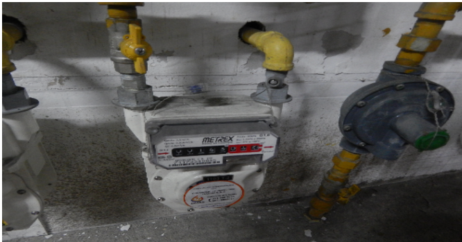
Contador de Gas
