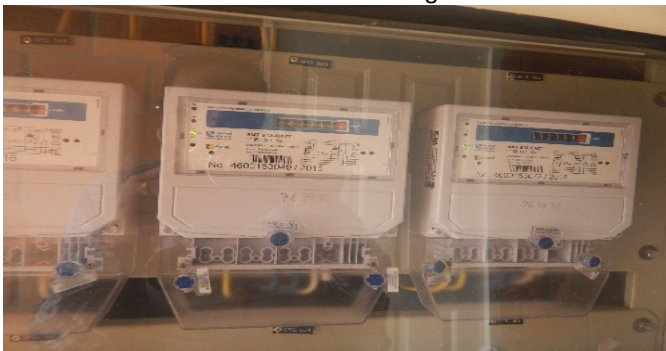
Contador de Energia
