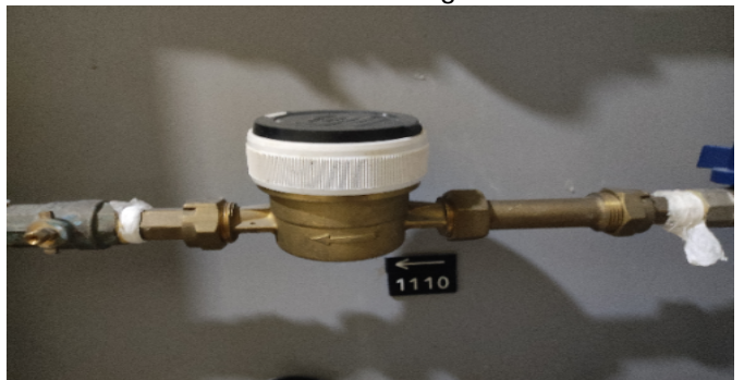
Contador de Agua
