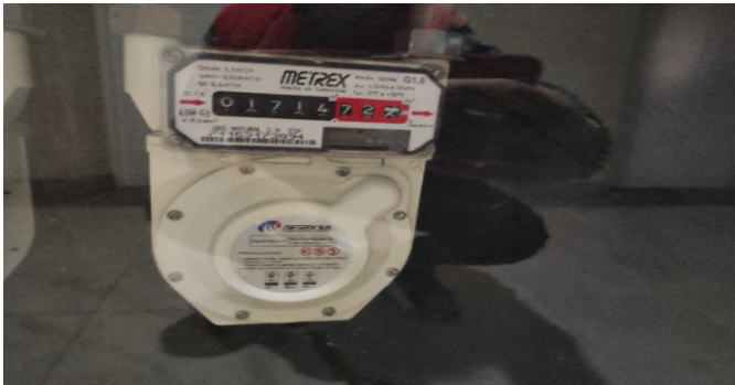
Contador de Gas
