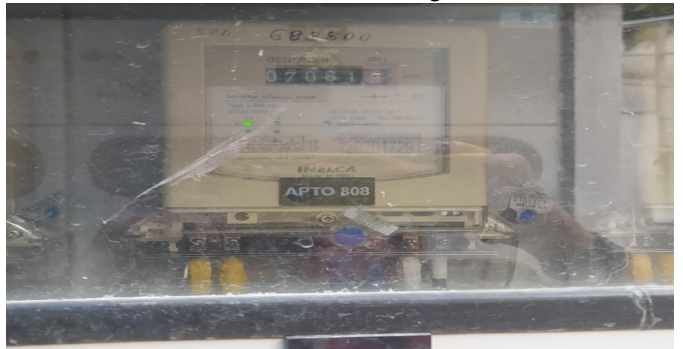
Contador de Energia
