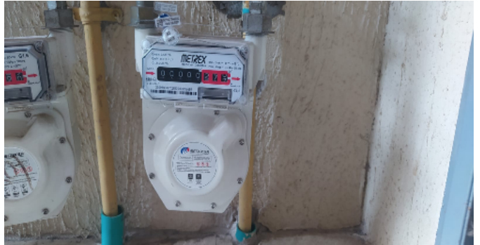
Contador de Gas
