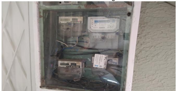
Contador de Energia
