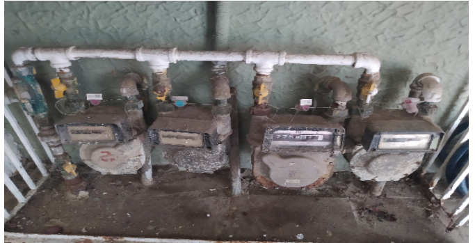
Contador de Gas
