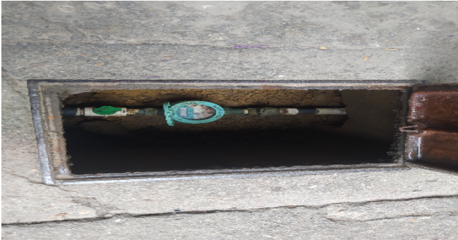
Contador de Agua
