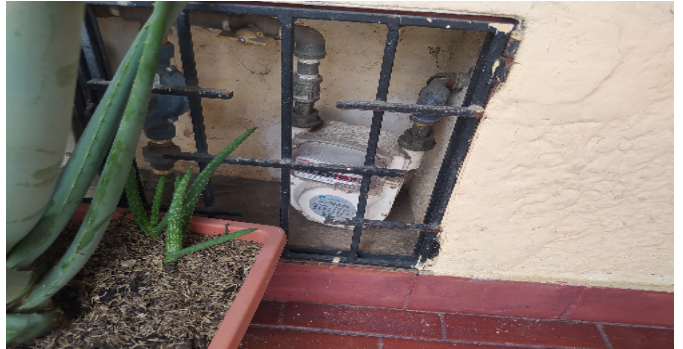
Contador de Gas
