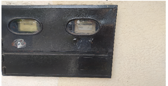
Contador de Energia
