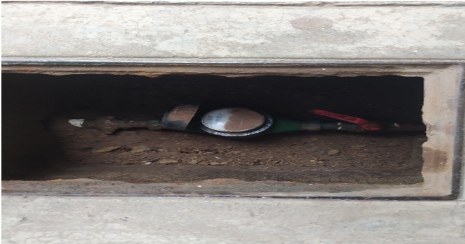
Contador de Agua
