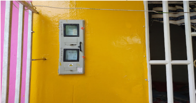
Contador de Energia
