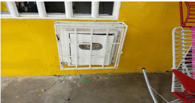
Contador de Gas
