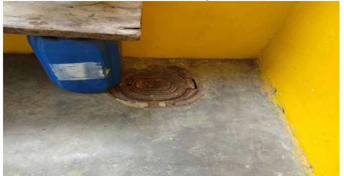
Contador de Agua
