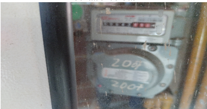
Contador de Gas
