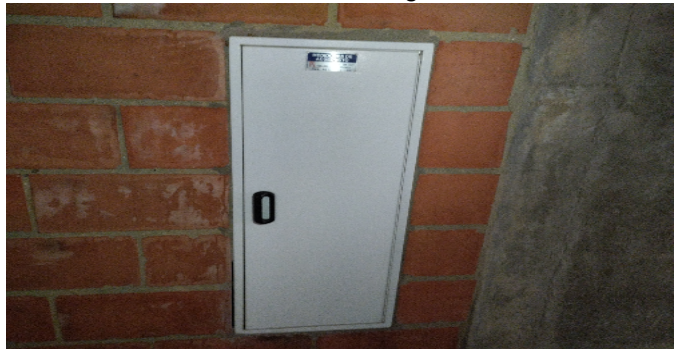
Contador de Agua
