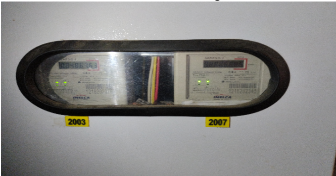
Contador de Energia
