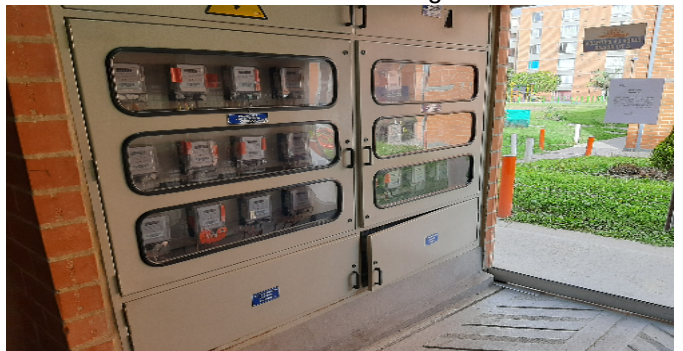
Contador de Energia
