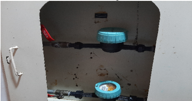
Contador de Agua
