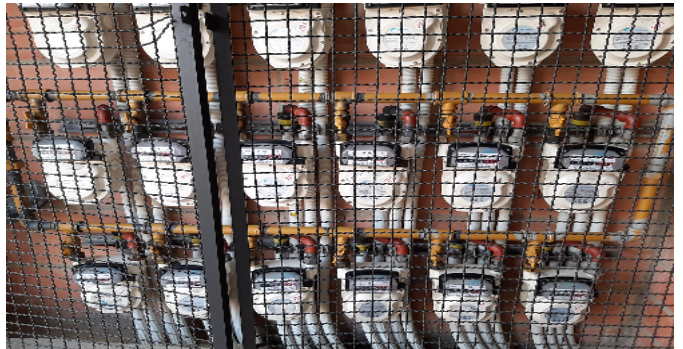
Contador de Gas
