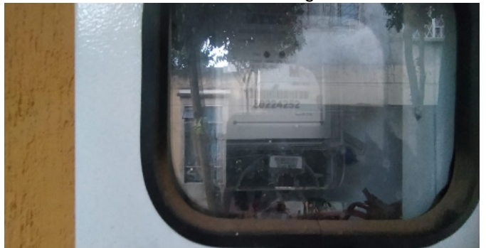
Contador de Energia
