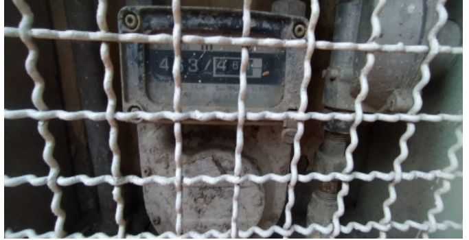
Contador de Gas
