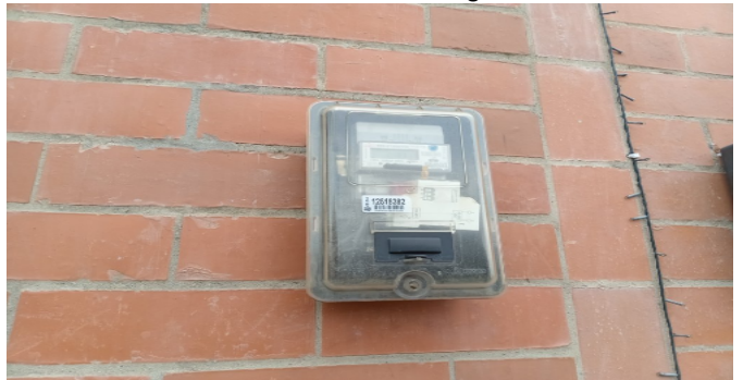
Contador de Energia
