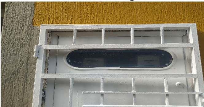
Contador de Energia
