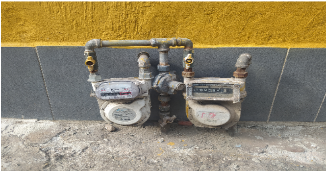
Contador de Gas
