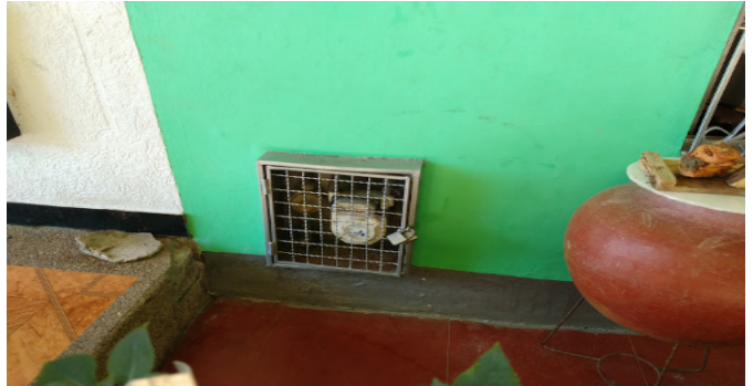
Contador de Gas
