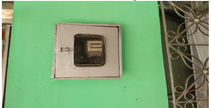
Contador de Energia
