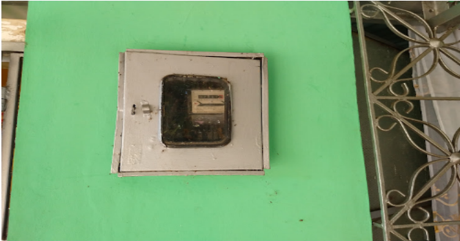
Contador de Energia
