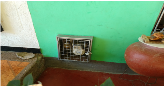
Contador de Gas
