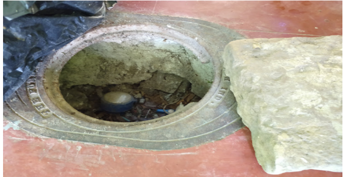
Contador de Agua
