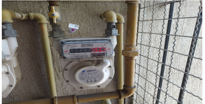
Contador de Gas
