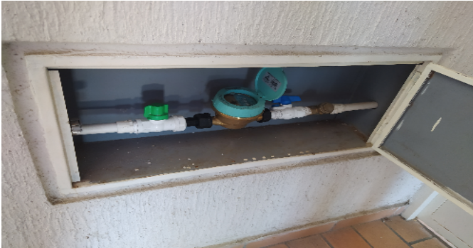
Contador de Agua
