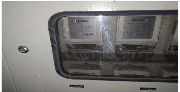
Contador de Energia
