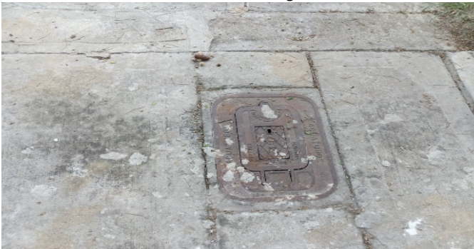
Contador de Agua
