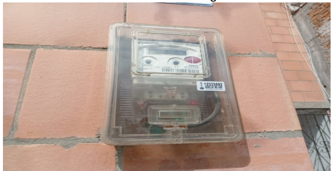
Contador de Energia
