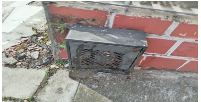
Contador de Gas
