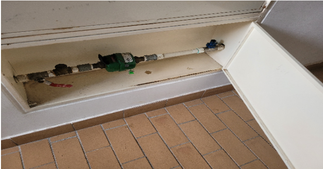
Contador de Agua
