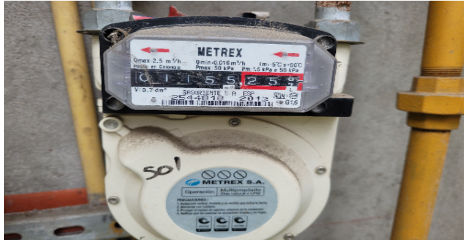
Contador de Gas
