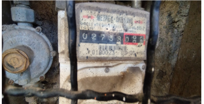
Contador de Gas
