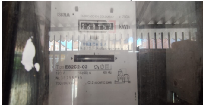
Contador de Energia
