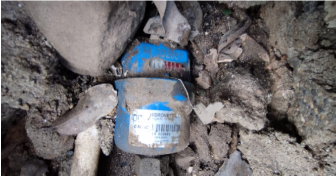
Contador de Agua
