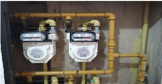
Contador de Gas
