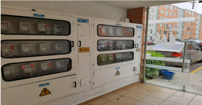
Contador de Energia
