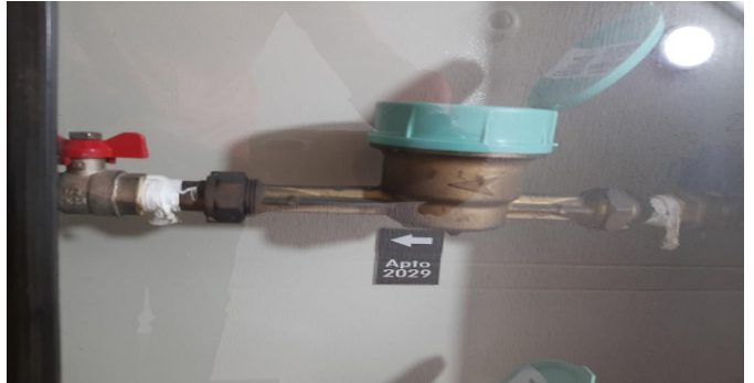
Contador de Agua
