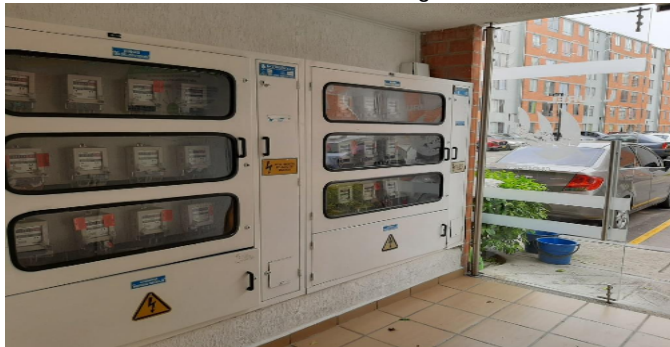
Contador de Energia
