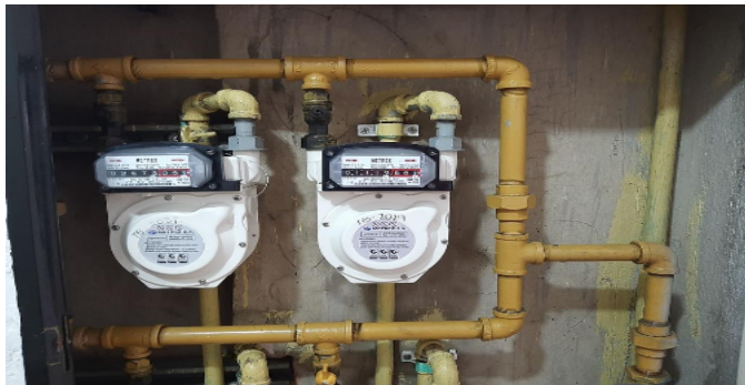
Contador de Gas
