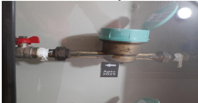
Contador de Agua
