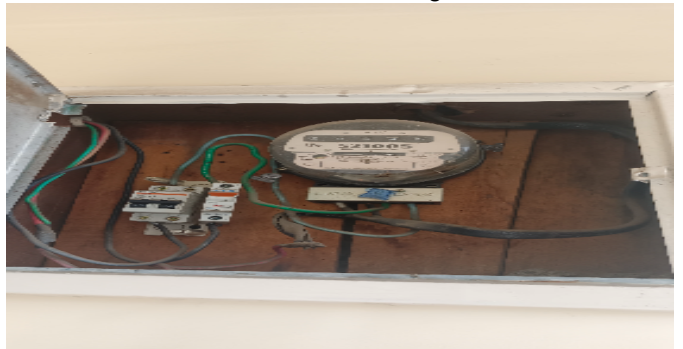
Contador de Energia
