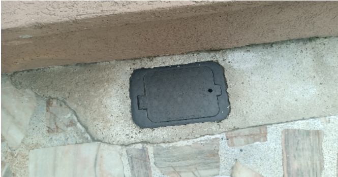
Contador de Agua
