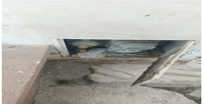
Contador de Gas
