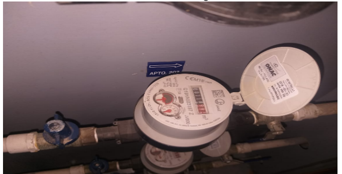
Contador de Agua
