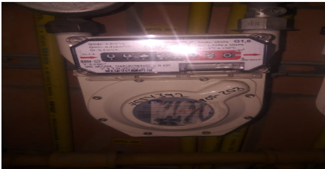
Contador de Gas
