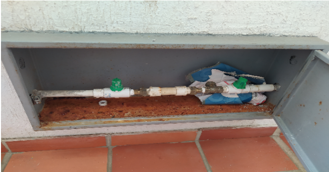
Contador de Agua
