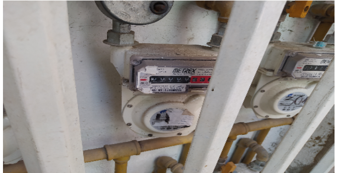
Contador de Gas
