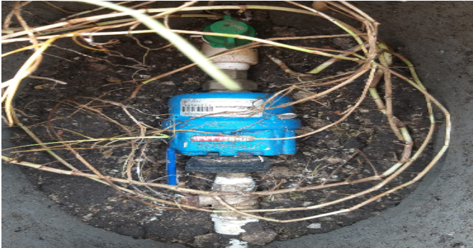
Contador de Agua
