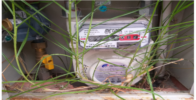
Contador de Gas
