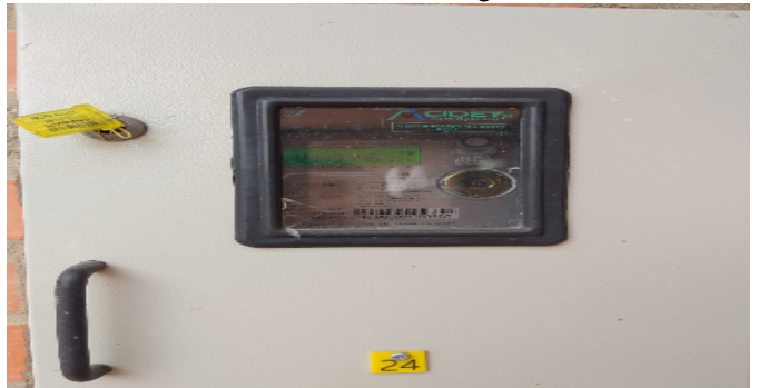
Contador de Energia
