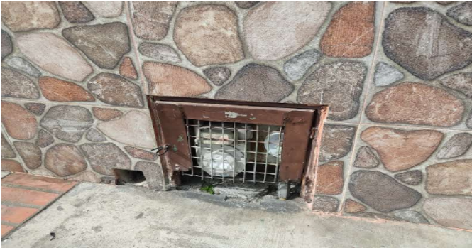
Contador de Gas
