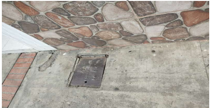
Contador de Agua
