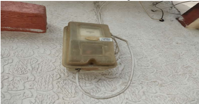
Contador de Energia
