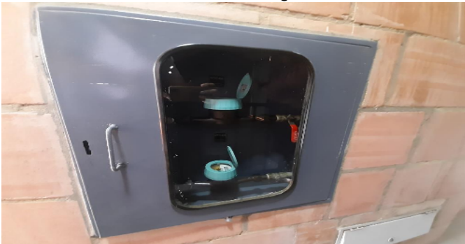
Contador de Agua
