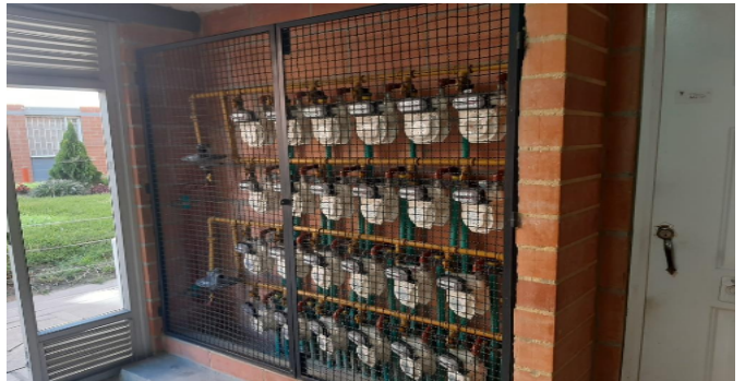
Contador de Gas
