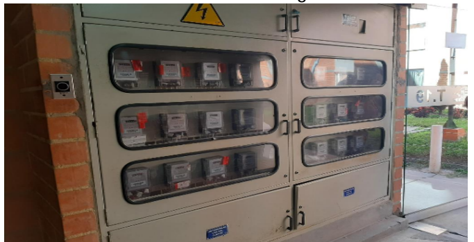
Contador de Energia
